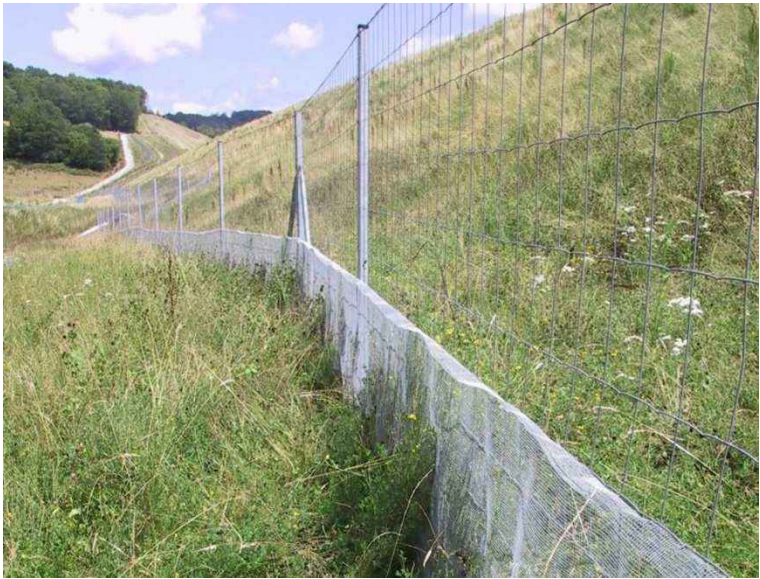
Figure 57 : Clôture à maille fine interdisant l’accès aux amphibiens (Source : Egis)
