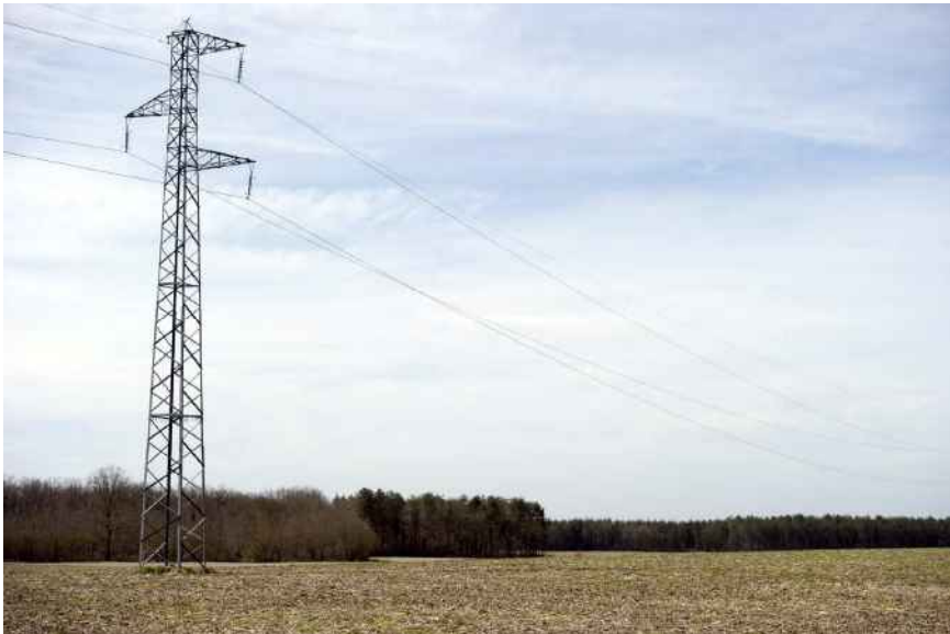
Figure 77: Ligne électrique à La Ville-Dieu-du-Temple (Source : SNCF Réseau - Paul Robin)
