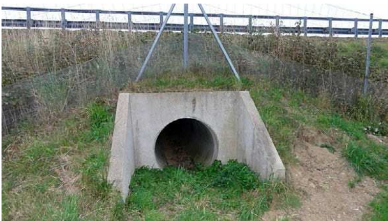
Figure 140: Batrachoduc et clôture spécifique à mailles fines (Source : Egis)
