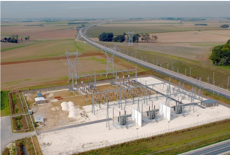
Figure 302: Exemple de sous-station électrique
