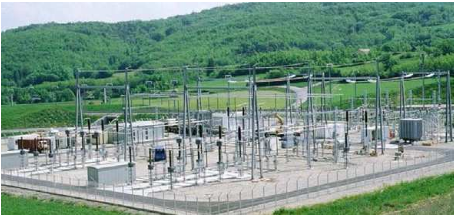
Figure 265: Exemple de sous-station (Source : SNCF RÉSEAU)
